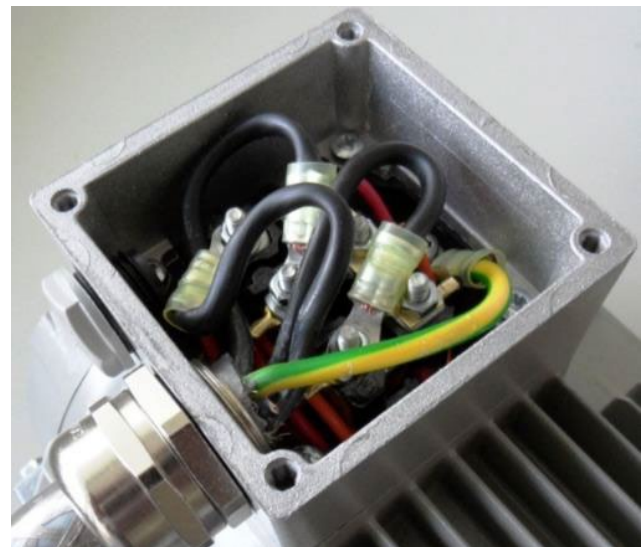
Abb. 32: Verdrahtung am Motoranschlusskasten
